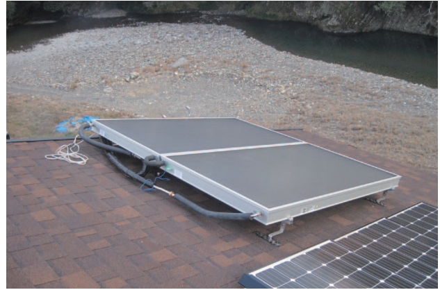
取り付けられた集熱器。右は太陽電池モジュール
