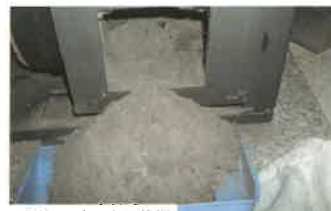
薪ストーブの清掃状況
