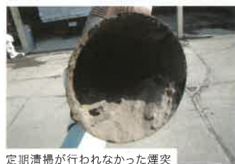
定期清掃が行われなかった煙突
